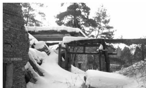
«Останки» очистных сооружений
