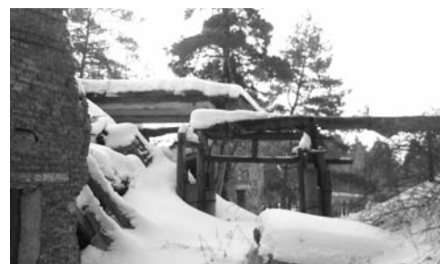
«Останки» очистных сооружений
